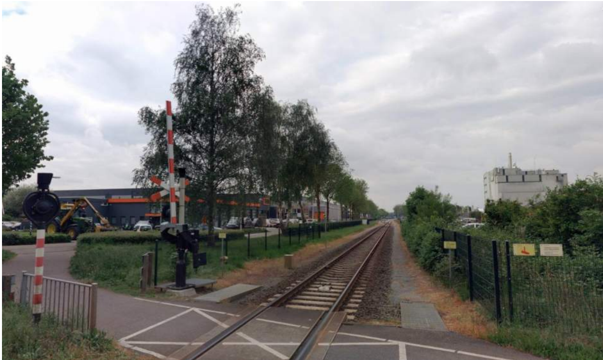
Figuur 28: Beeld vanaf de Bievankweg te Wehl waar struiken door het hekwerk groeien. (Cyclomedia)
