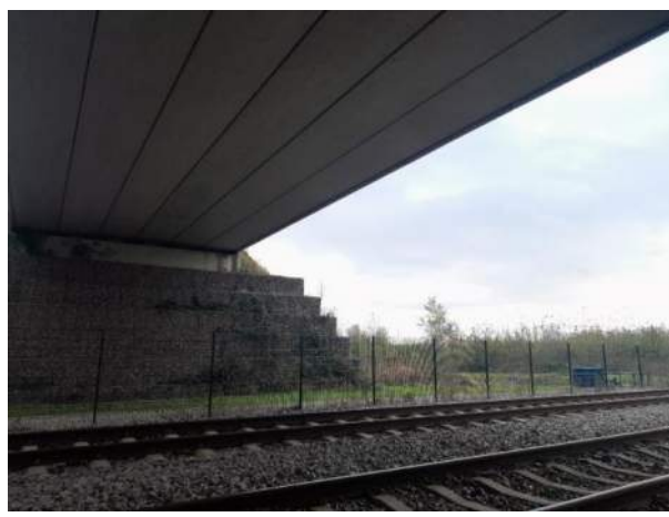
Figuur 3.16: Viaduct met aan de onderzijde spleten die geschikt zijn voor vleermuizen.
