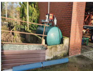
foto 1 - ter plaatse bovengrondse tank
