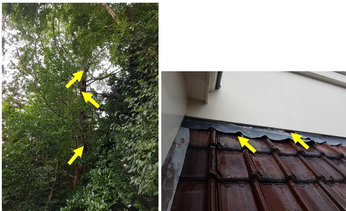
Figuur 5. Locaties van spechtenholen in de moerascipres (links) en openingen onder een dakrand en loodslabben van het landhuis (rechts).
