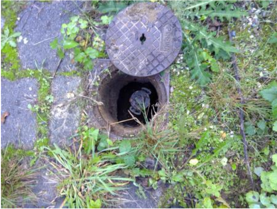
F1 ondergrondse tank
