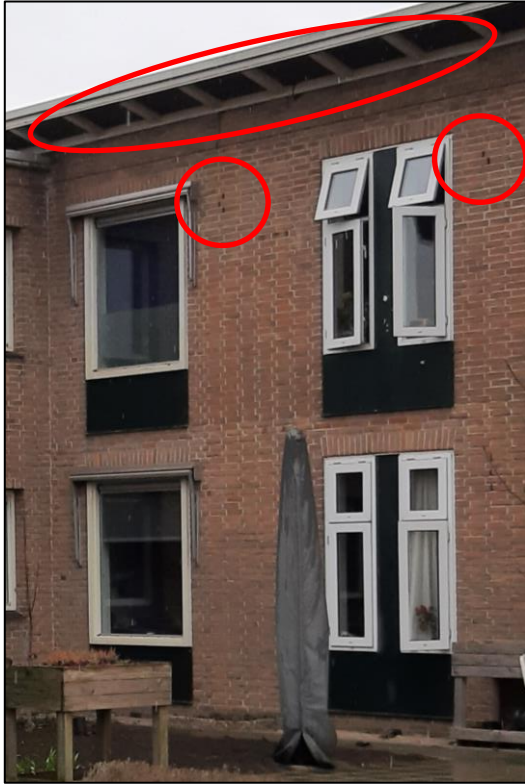
Figuur 9 Een deel van de gevel van het westelijke gebouw is mogelijk geschikt als nestlocatie voor gierzwaluw en huismus door een ruimte tussen het overstek en de toegang tot de spouw door middel van erg grote open voegen
