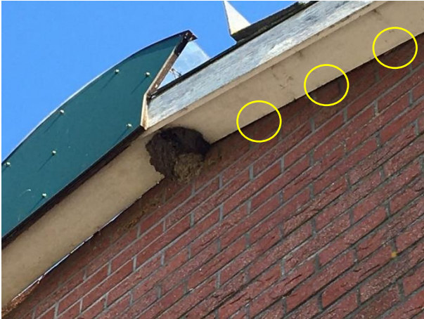
Er zijn kieren (gele cirkels) waargenomen tussen de betimmering van het dak overstek en de buitengevels van de ligboxenstal.
