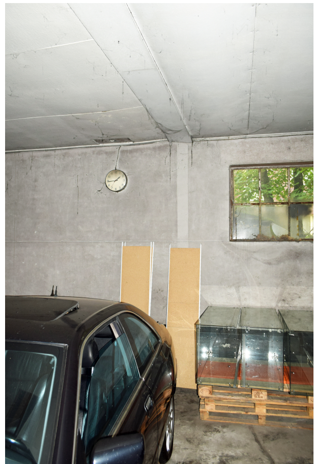
De aftekening van een voormalige binnenwand aan de achterzijde op de achterwand en op het zachtboard plafond.
