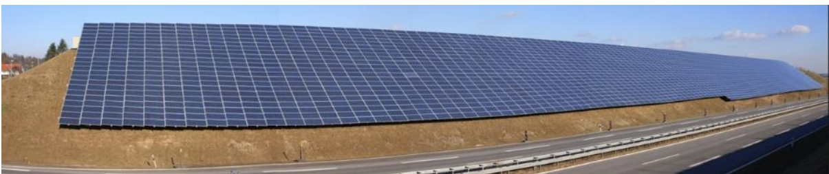
Afbeelding 24: Zonne installatie langs de a94 dicht bij Togg
