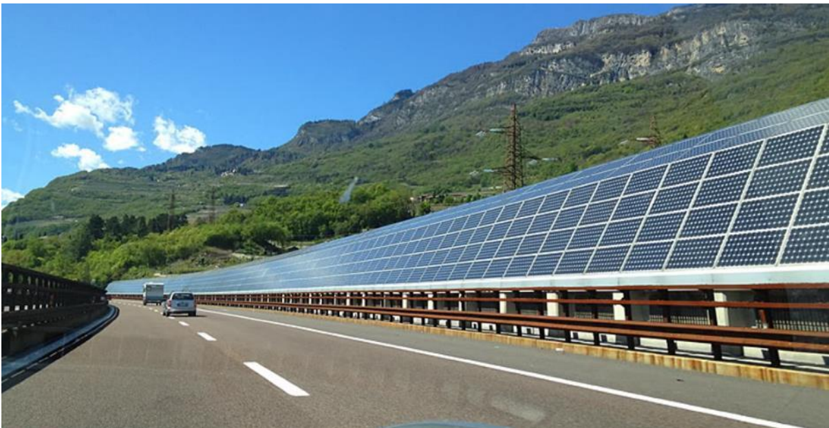
Afbeelding 23: Zonne installatie langs de "Brennerautobahn" in Italië
