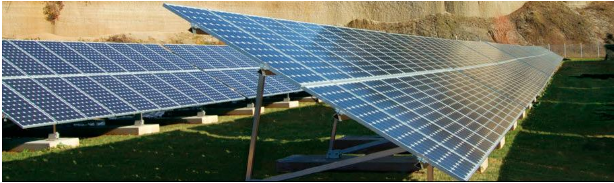
Afbeelding 21: Voorbeeld onderconstructie met betonvoeten
