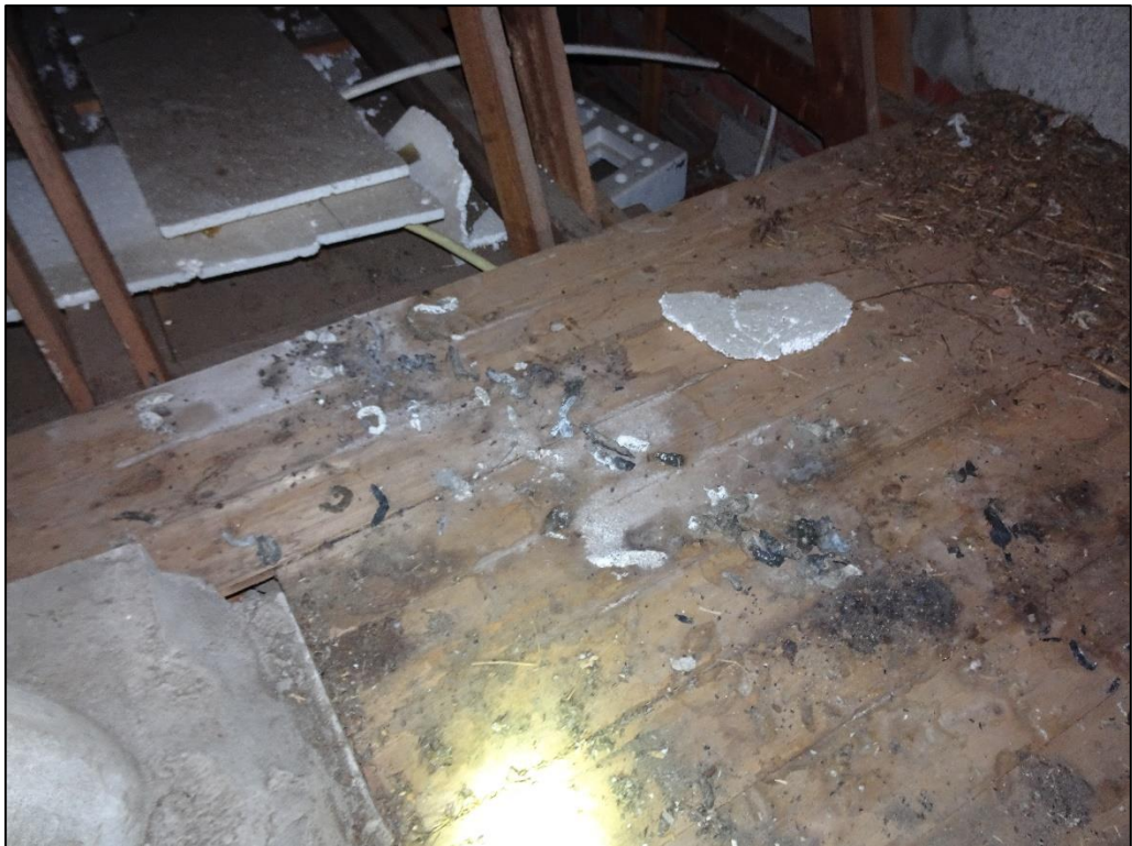
Op de zolder waren veel poesporen aanwezig. Dit duidt op gebruik door een steenmarter.
